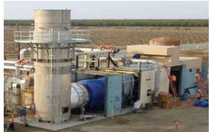
CES OFT-900 turbine
